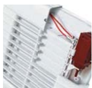
Вентилятор не работает (жалюзи ЗАКРЫТЫ)
